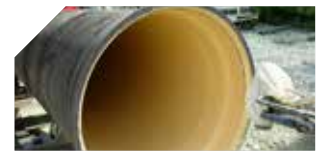
Pipelines et Terminaux
